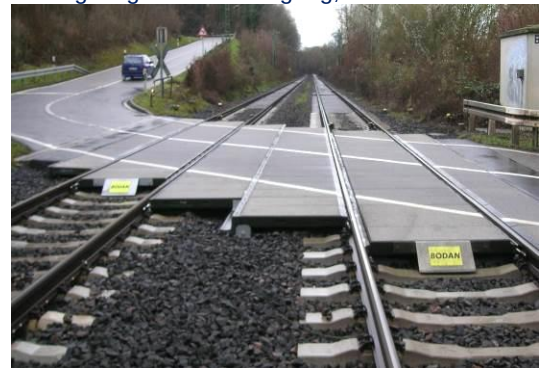
Foto 17 Fertig eingebauter Übergang, Deutschland
